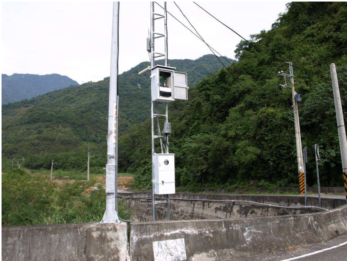
圖附錄 3-14 大龍橋無線傳輸接收端設備
