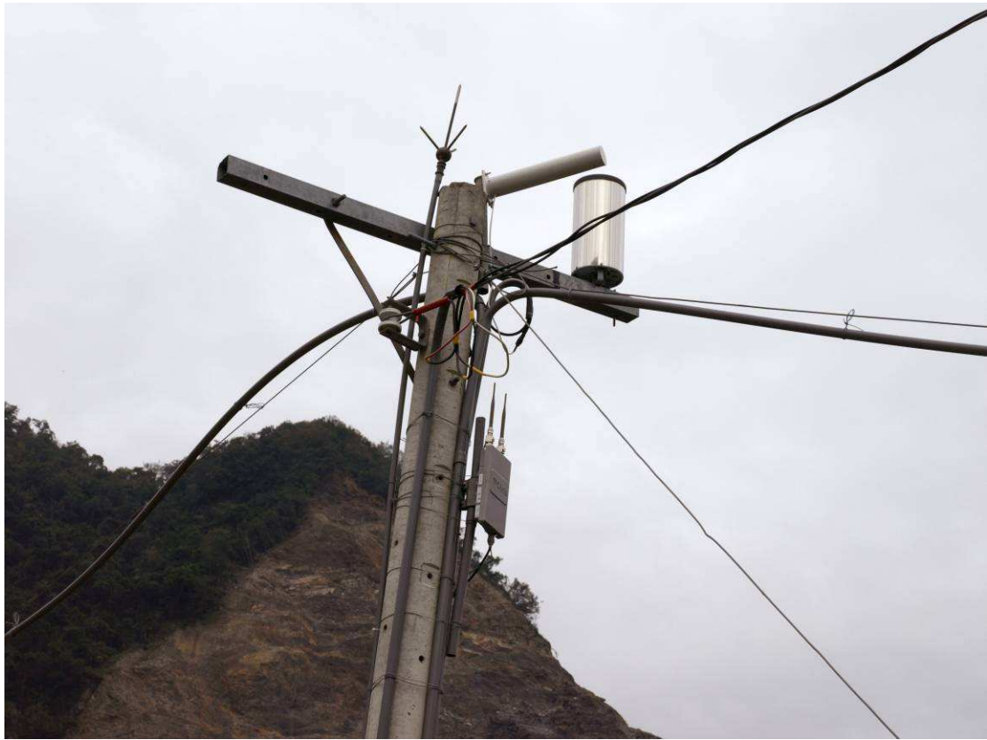
圖附錄 3-13 苗圃上方無線傳輸發送端設備
