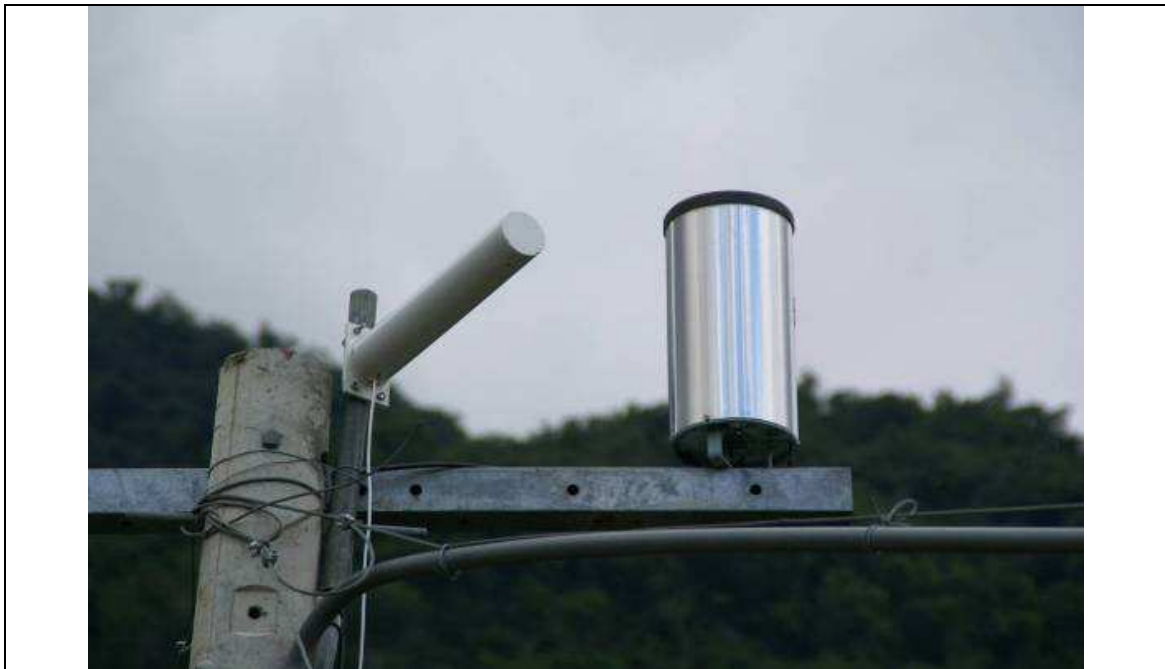
圖 3-2-3 雨量計(現地照片)
