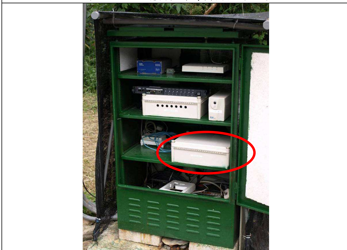
圖 3-4-9 GSM 無線傳輸設備
