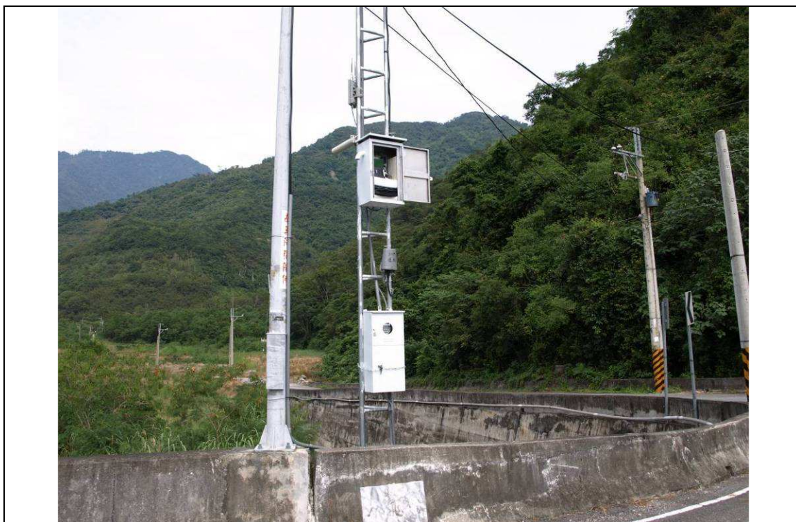
圖 3-4-8 大龍橋無線傳輸接收端設備
